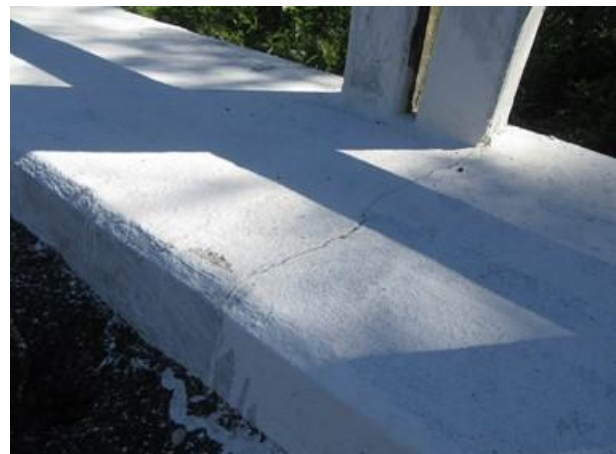
Foto 39: Passeio Leste - Fissura.
