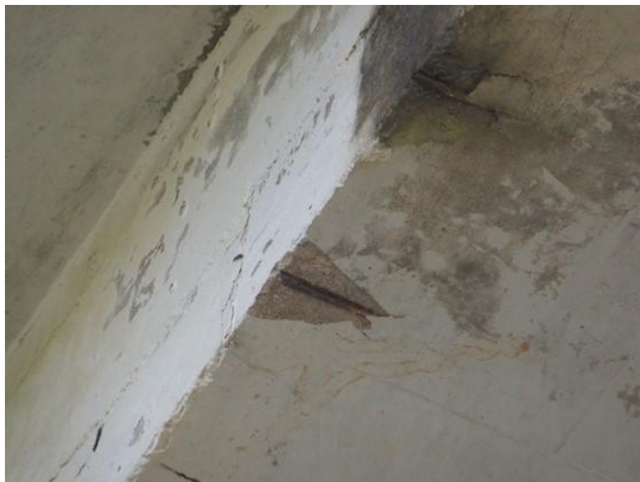
Foto 58 (IMG_0790) Balanço leste – Armadura exposta/oxidada e cobertura insuficiente.
