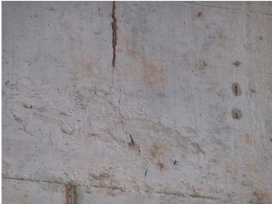
Foto 35 (IMG_0853): Viga Transversina 2 – Face sul - Fissura.
