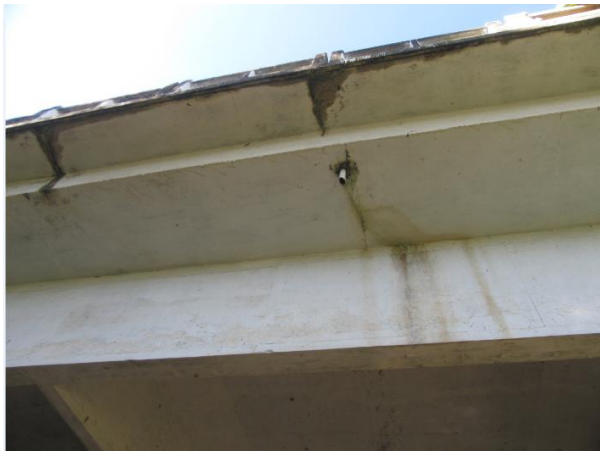
Foto 14: Viga Longarina Leste – Mancha de umidade .
