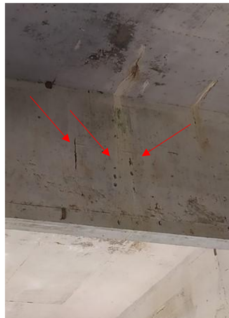
Foto 19: Transversina 2 - Armadura exposta e fissuras verticais
