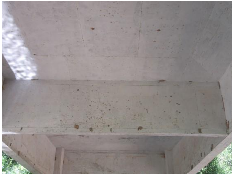
Foto 41 (IMG_0980) Viga transversina 2 – face norte – fissuras..
