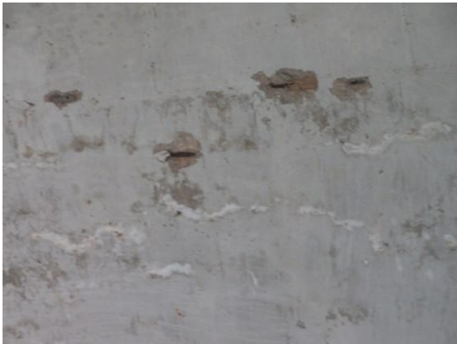
Foto 22 (IMG_0833): Tabuleiro balanço 1 – Manchas de umidade, eflorescência e armadura exposta/oxidada.
