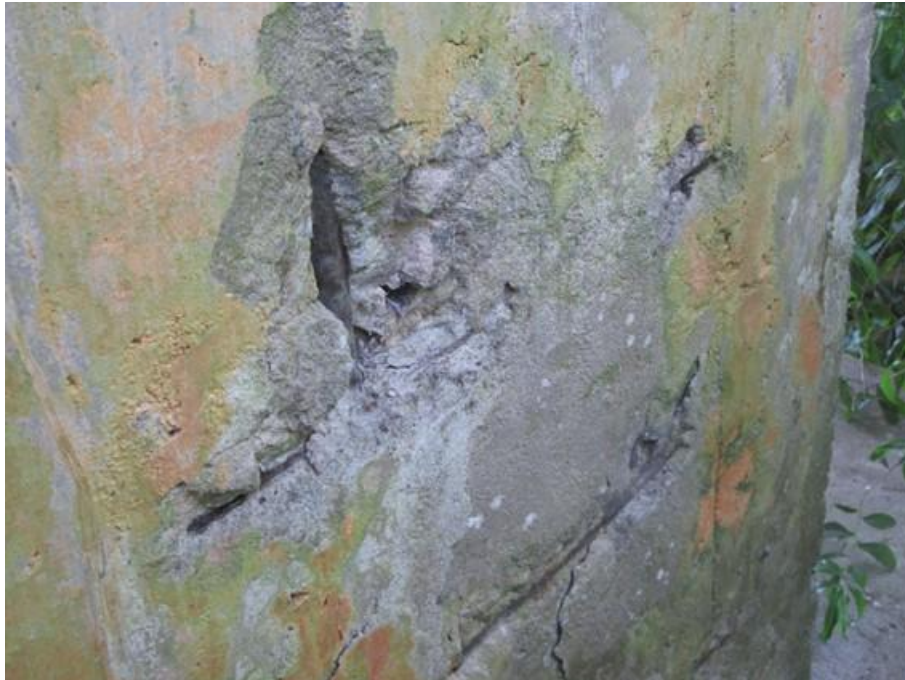
Foto 55 (IMG_0951) Pilar oeste – Apoio 2 – Face Leste – Armadura exposta/oxidada e cobrimento insuficiente.
