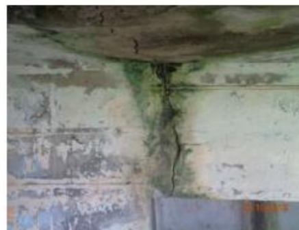
Foto 4. Fissura/Trinca com abertura \geq 1,0\text{mm} na laje em balanço e viga longitudinal.
