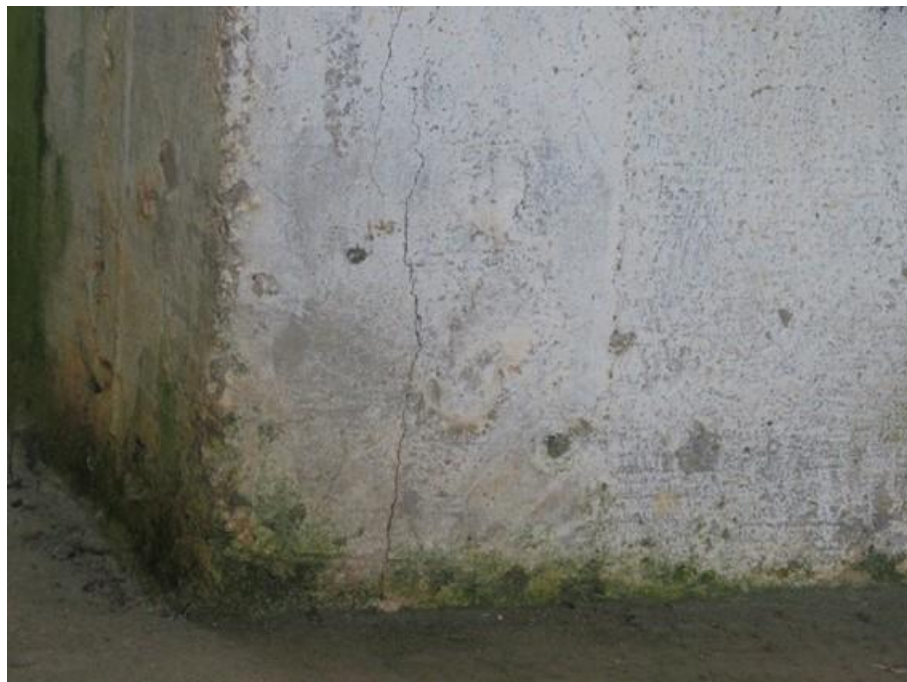
Foto 52 (IMG_0942) Pilar oeste – apoio 2 - Fissuras.
