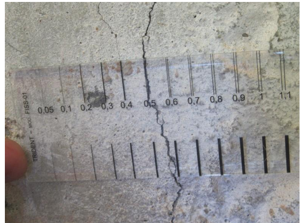
Foto 27: Abertura de fissura igual a 0,5 mm.
