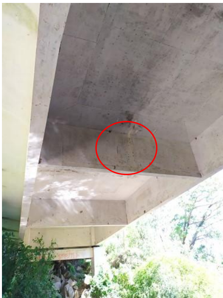
Foto 18: Transversina 2 - Armadura exposta e fissuras verticais.
