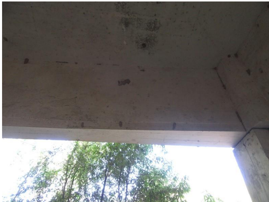
Foto 30 (IMG_0823): Face interna - Viga longarina Leste - Vão - Manchas de umidade.
