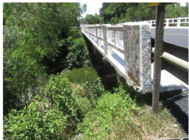
Foto 47: Talude – Ausência de drenagem.
