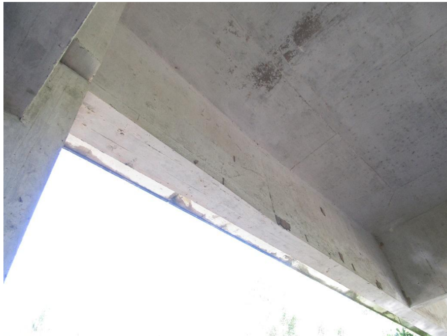
Foto 33 (IMG_0844): Viga longarina oeste – Face interna – Armadura exposta..
