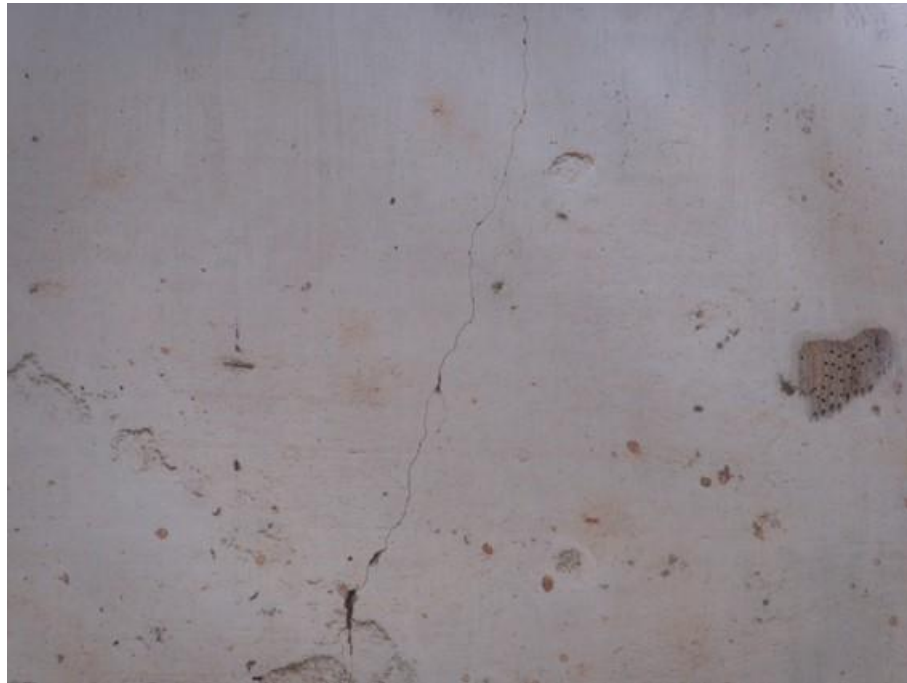
Foto 37 (IMG_0854) Viga transversina 3 – fissura vertical.
