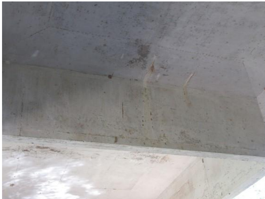
Foto 34 (IMG_0852): Viga Transversina 2 – Face sul – Fissuras e eflorescências.
