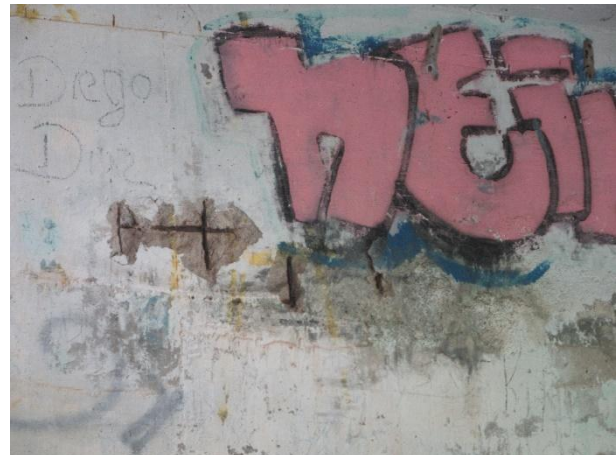
Foto 21: Cortina 2 – Armadura exposta.
