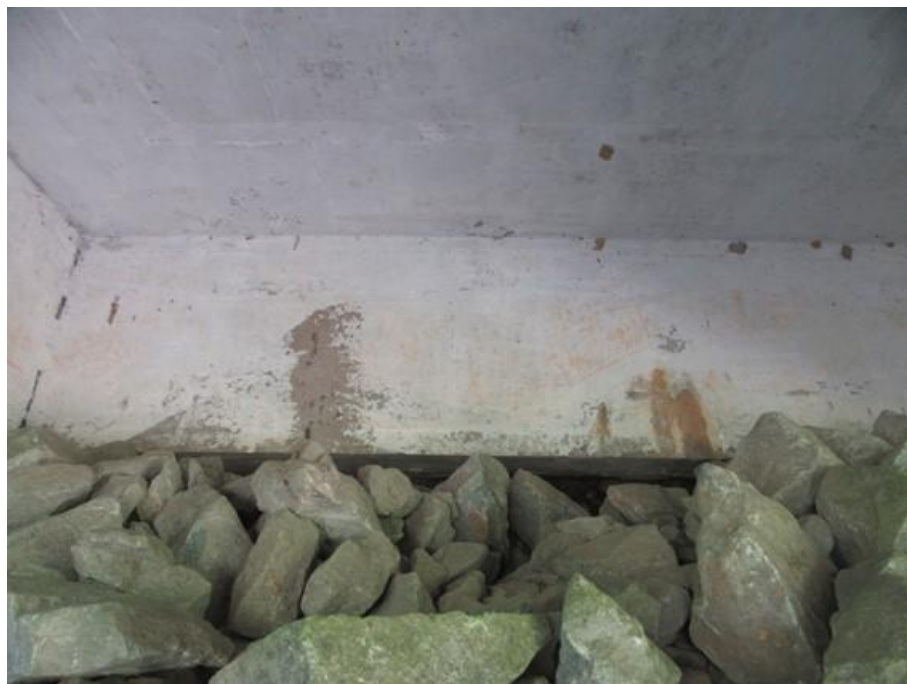
Foto 32 (IMG_0827): Cortina 1 – Balanço 1 – Manchas de umidade.
