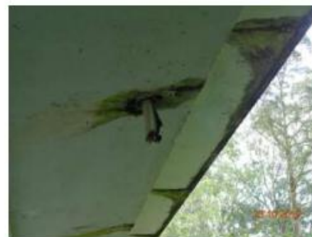
Foto 8. Vista da laje em balanço com umidade e buzinote deteriorado.
