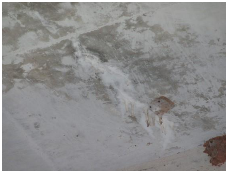
Foto 28 (IMG_0925): Tabuleiro balanço 2 - Manchas de umidade e eflorescência com formação de estalactites.
