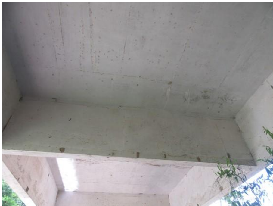
Foto 38 (IMG_0976) Viga transversina 3 – face norte - fissuras.
