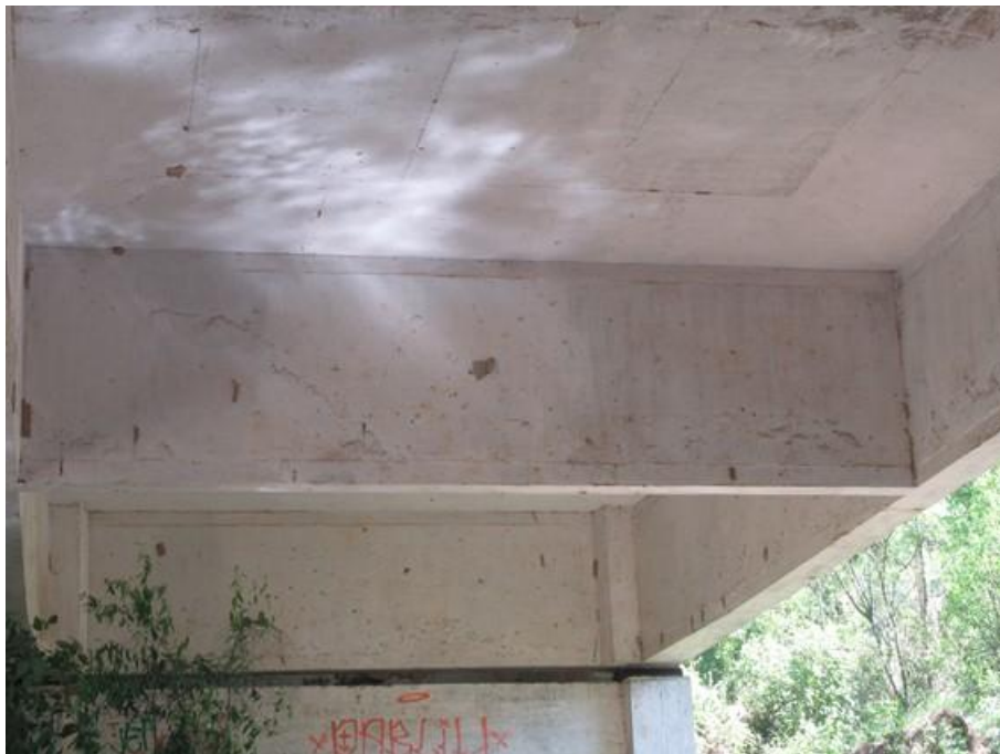
Foto 36 (IMG_0854): Viga Transversina 3 – face sul - Fissuras..
