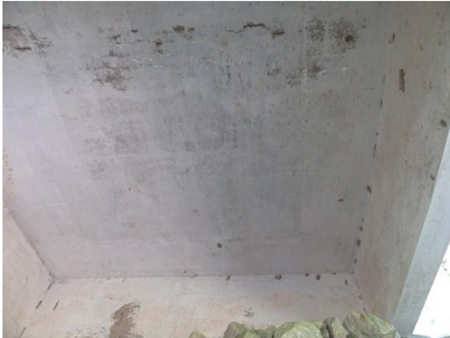
Foto 21 (IMG_0830): Tabuleiro balanço 1 – Manchas de umidade, eflorescência e armadura exposta.
