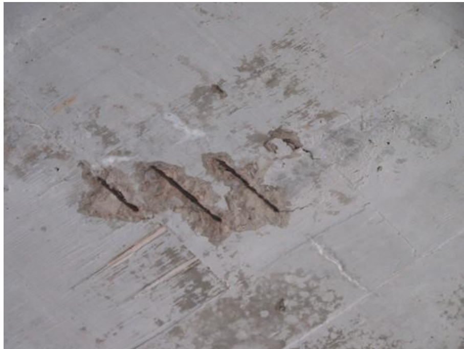
Foto 25 (IMG_0841): Tabuleiro Vão – Armadura exposta/oxidada.
