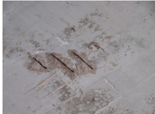
Foto 9: Tabuleiro – Vão 2 – Armadura exposta.
