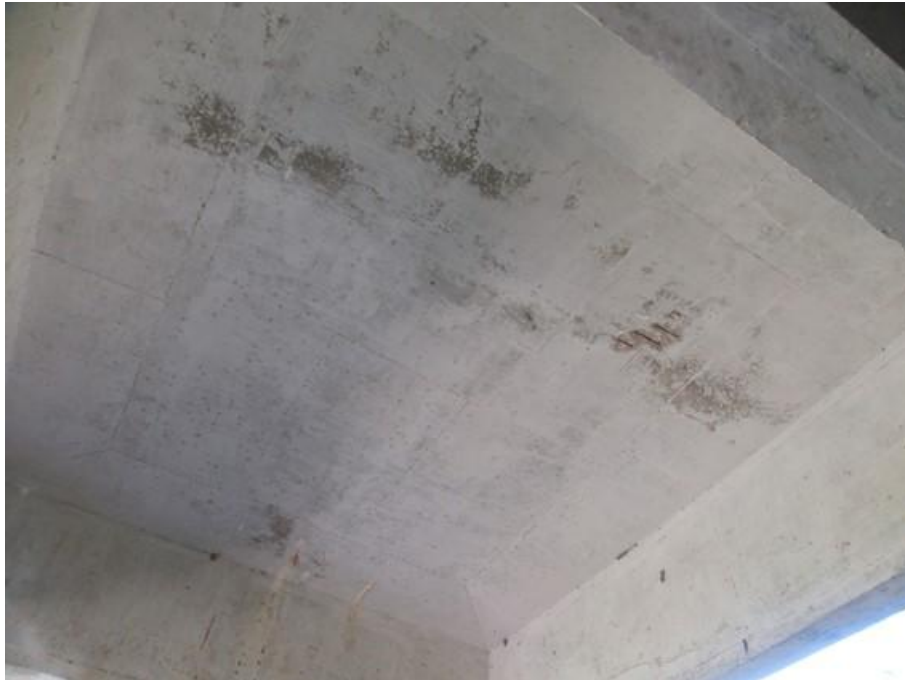
Foto 23 (IMG_0839): Tabuleiro vão – Manchas de umidade, eflorescência e armadura exposta.
