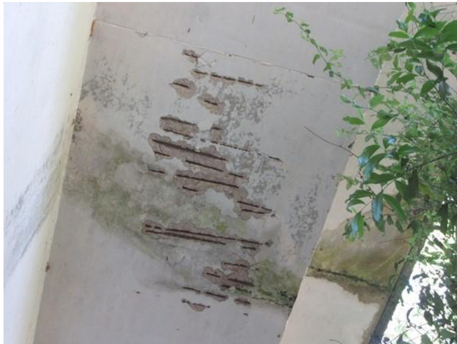
Foto 65 (IMG_0800) Balanço oeste – Armadura exposta/oxidada e cobertura insuficiente.
