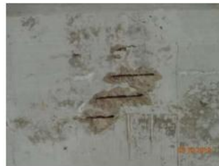
Foto 6. Concreto disgregado com armadura exposta e corroída na viga transversina.
