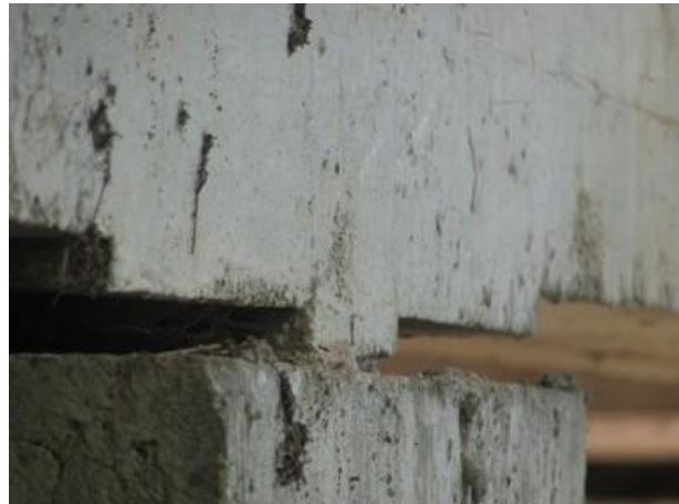
Foto 23: Articulação do concreto do tipo Freyssinet – Acúmulo de detritos.
