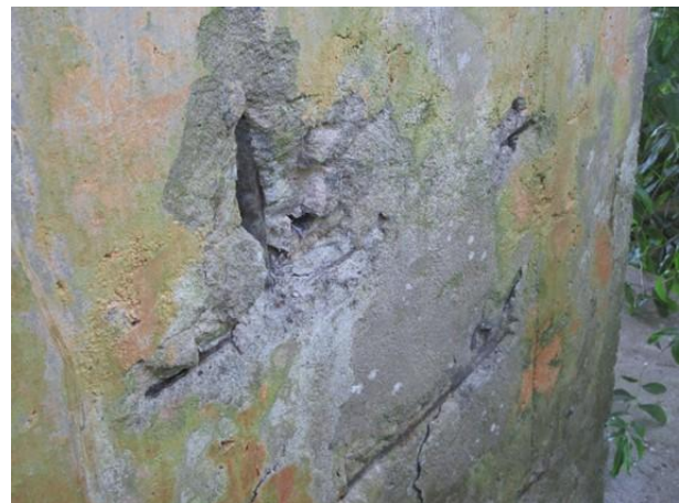
Foto 29: Pilar oeste – Apoio 2 – Armadura exposta e cobertura deficiente.
