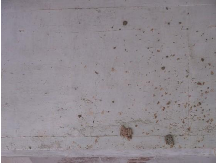
Foto 43 (IMG_0983) Viga transversina 2 – face norte – fissura vertical
