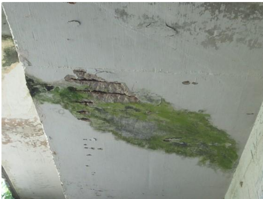
Foto 68 (IMG_0907) Balanço Oeste – Vista Sul/Norte – Armadura exposta/oxidada e manchas de umidade.
