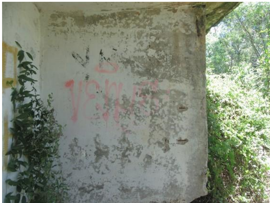
Foto 84 (IMG_0994) Ala Oeste – Cortina 2 (Norte) – Armadura exposta.
