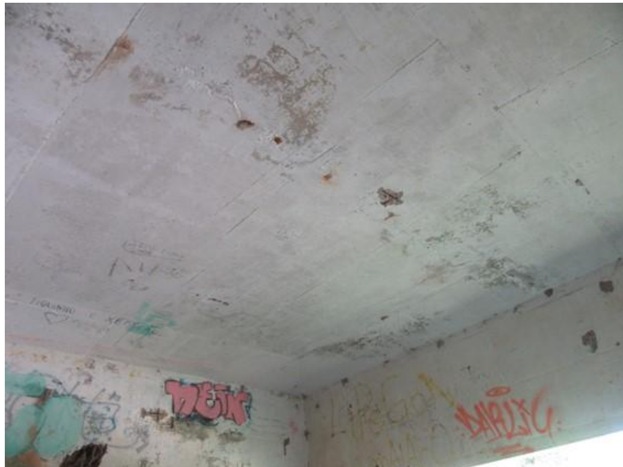
Foto 27 (IMG_0923): Tabuleiro balanço 2 – Manchas de umidade, eflorescência e armadura exposta.
