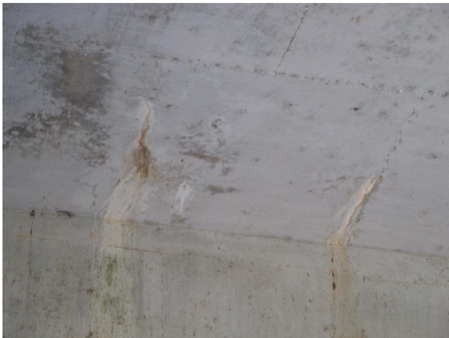
Foto 24 (IMG_0840): Tabuleiro Vão – Manchas de umidade e eflorescência – Vista Transversina 1.
