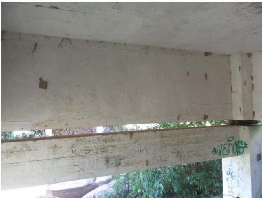
Foto 44 (IMG_0927) Viga transversina 4 – face norte – fissuras.
