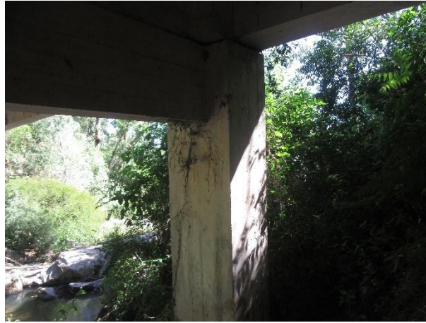
Foto 30: Viga Travessa – Face inferior – Baixo cobrimento.
