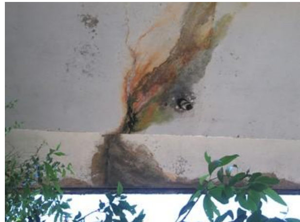
Foto 15: Viga Longarina Oeste – Mancha de umidade.
