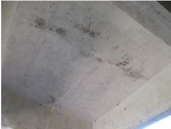
Foto 8: Tabuleiro – Vão 1 – Armadura exposta, eflorescência e estalactite.
