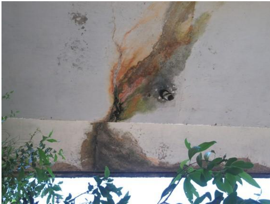
Foto 67 (IMG_0804) Balanço Oeste – Manchas de umidade, eflorescência e fissura.
