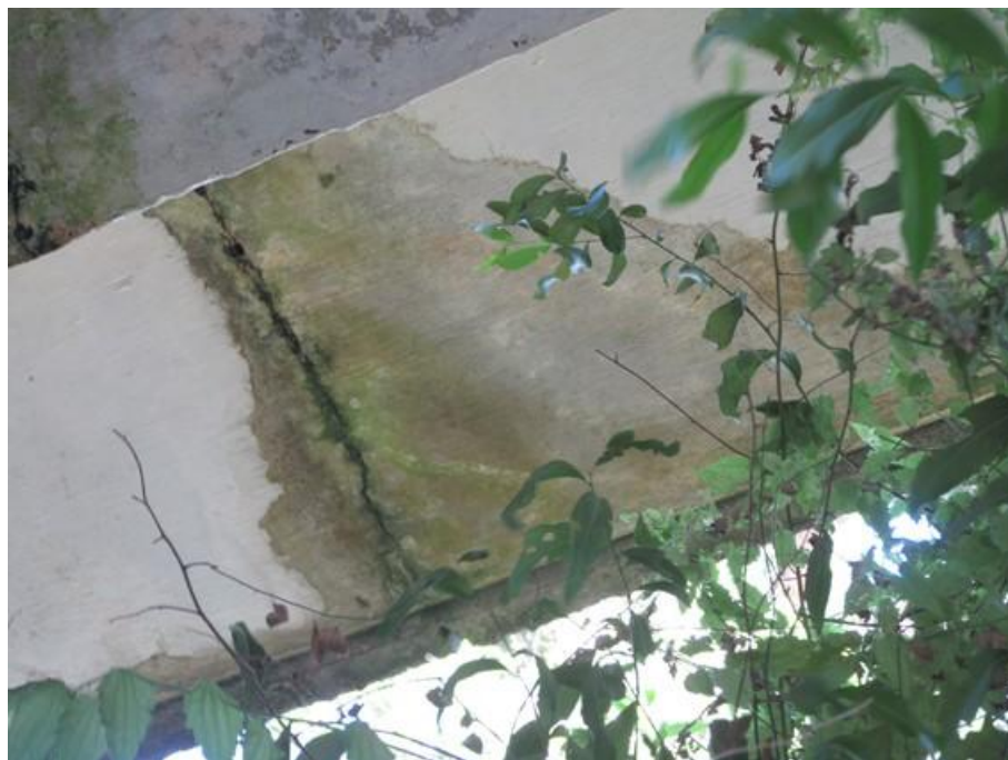
Foto 66 (IMG_0803) Balanço Oeste – Manchas de umidade e fissura.
