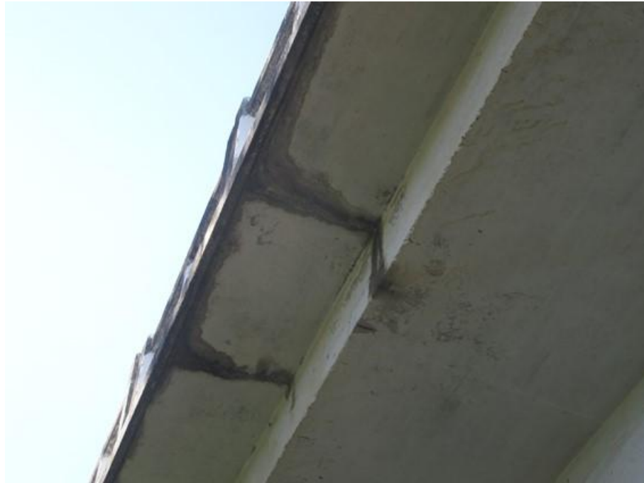
Foto 57 (IMG_0789) Balanço Leste – Manchas de umidade e armadura exposta.
