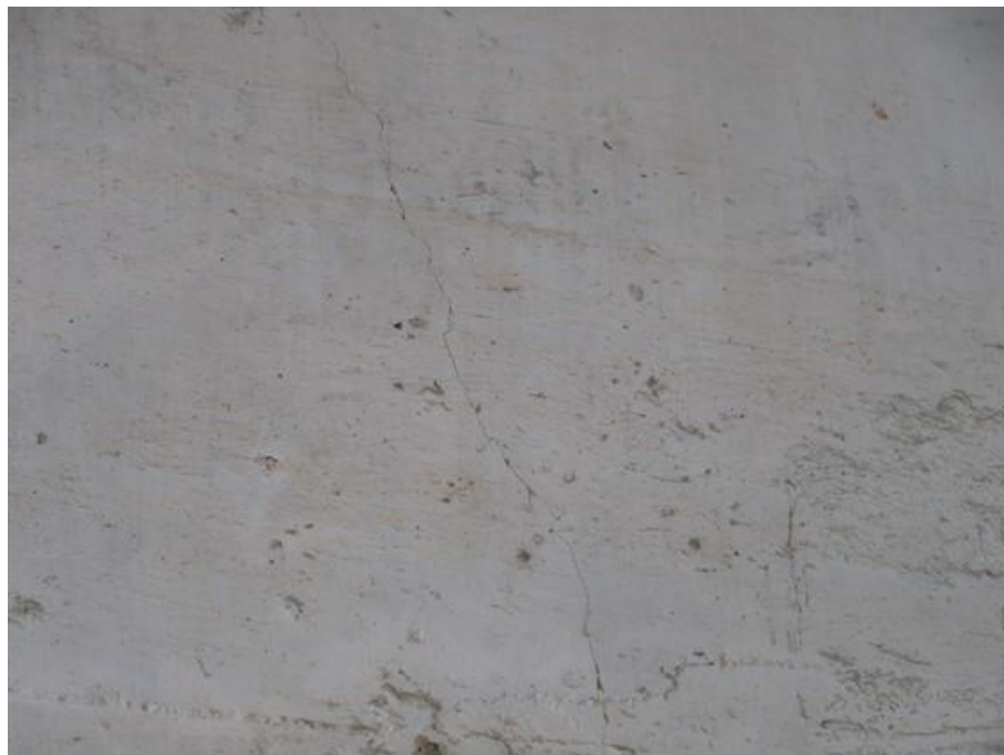
Foto 40 (IMG_0978) Viga transversina 3 – face norte – fissura diagonal.
