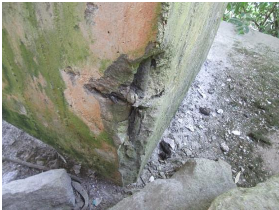
Foto 54 (IMG_0949) Pilar oeste – Apoio 2 Armadura exposta/oxidada face Norte/leste.
