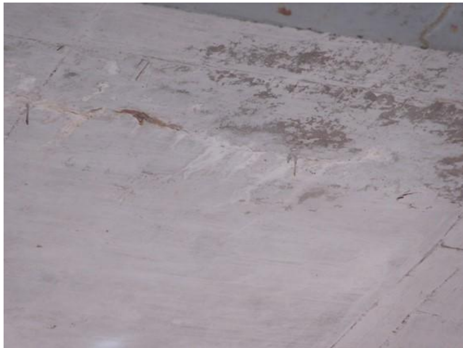
Foto 26 (IMG_0858): Tabuleiro Vão – Manchas de umidade e eflorescência com formação de estalactite.
