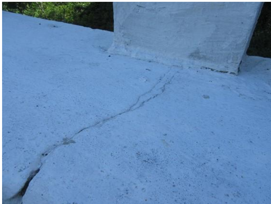
Foto 08 (IMG_0768): Fissura passeio/guarda corpo leste.
