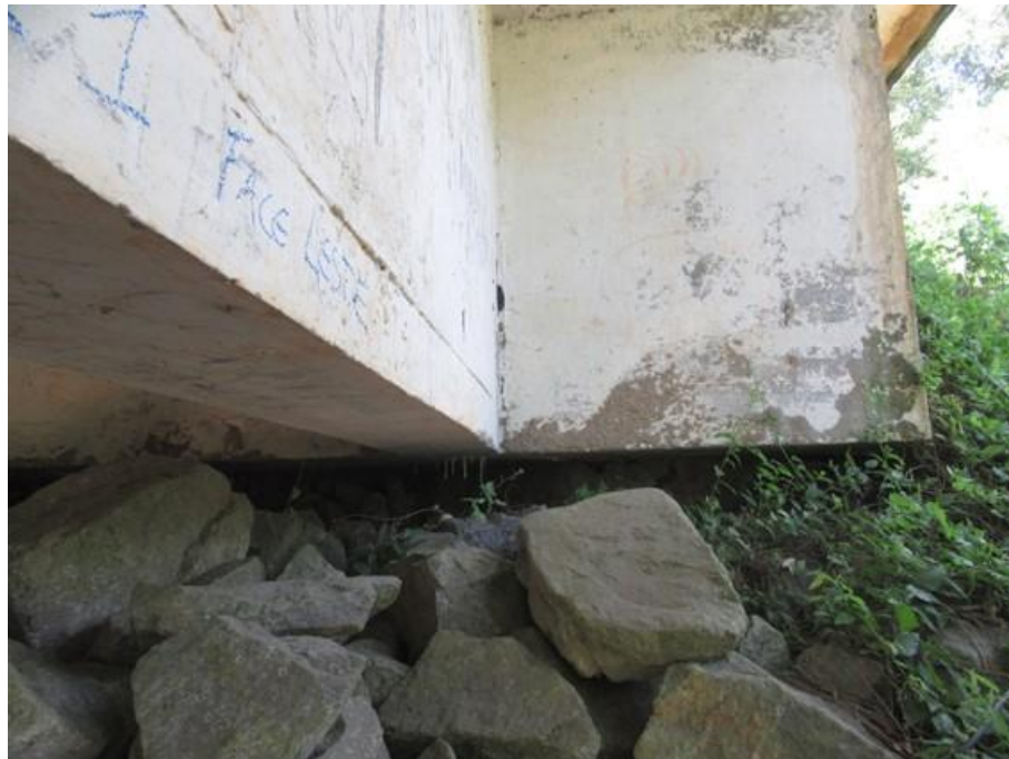
Foto 79 (IMG_0874) Cortina 1 (Sul) – Eflorescência e estalactites – Ausência de material sob obra.
