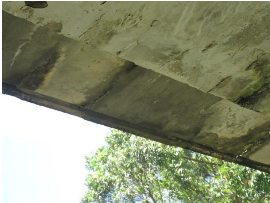
Foto 63 (IMG_0990) Balanço Leste – Manchas de umidade, eflorescência e armadura exposta/oxidada..
