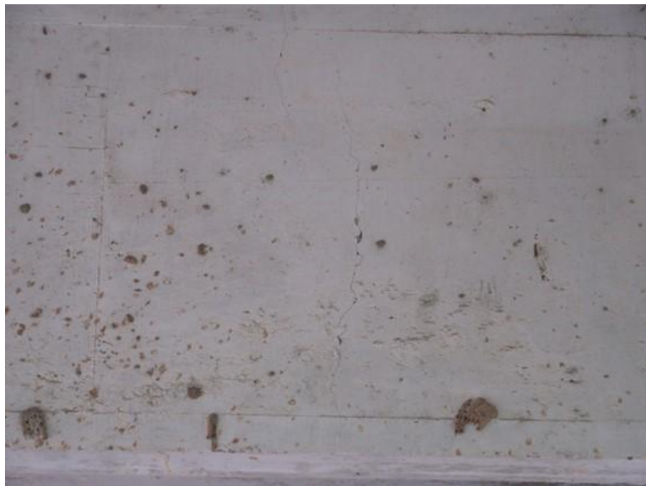
Foto 42 (IMG_0982) Viga transversina 2 – face norte– Fissuras verticais.
