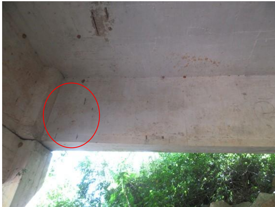
Foto 31 (IMG_0825): Viga longarina oeste – Vão - face interna – Armadura exposta/oxidada e cobertura deficiente.
