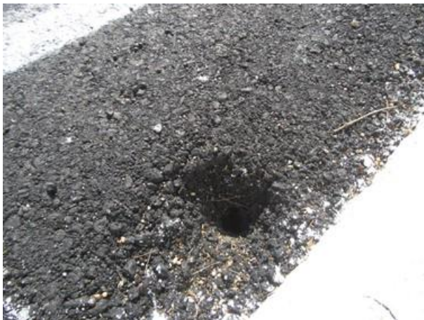
Foto 44: Bordo Oeste – Apenas 3 buzinotes com diâmetro inadequado.
