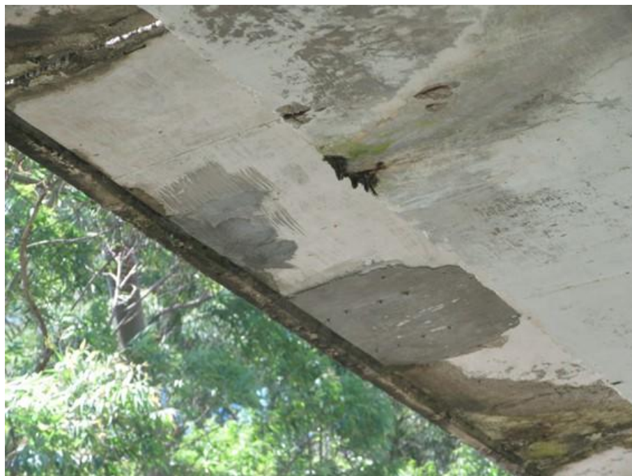
Foto 62 (IMG_0989) Balanço leste – Reparo inadequado.
