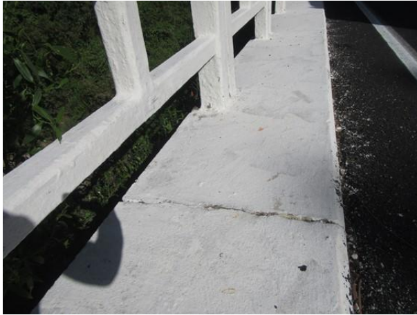
Foto 40: Passeio Oeste - Fissura.
