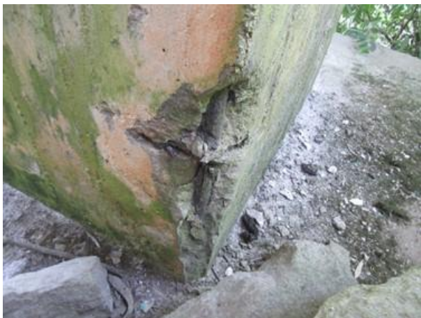
Foto 28: Pilar oeste – Apoio 2 – Armadura exposta e manchas de umidade.
