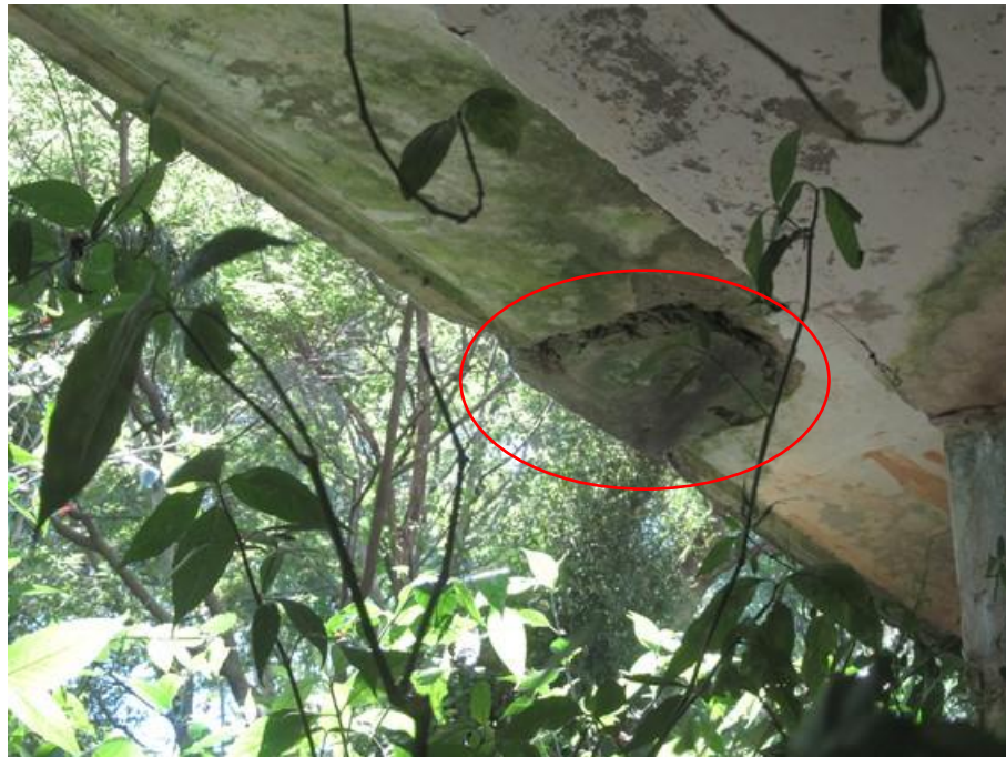
Foto 61 (IMG_0892) Balanço leste – Reparo inadequado.
