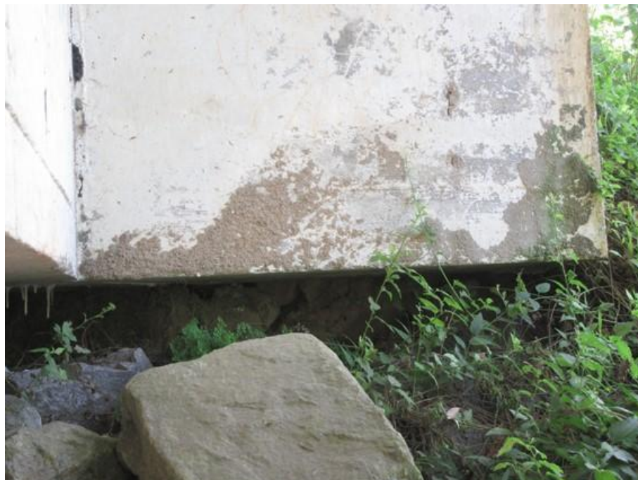
Foto 80 (IMG_0877) Cortina 1 (Sul) – Eflorescência e estalactites – Ausência de material sob obra.
