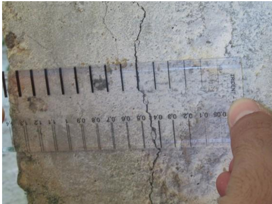
Foto 53 (IMG_0943) Pilar oeste – Apoio 2 – Abertura de fissura igual a 0,5mm.
