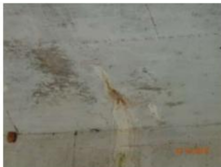
Foto 5. Fissura com eflorescência na laje em balanço.
