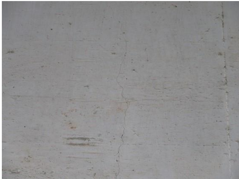
Foto 39 (IMG_0977) Viga transversina 3 – face norte – fissura vertical.
