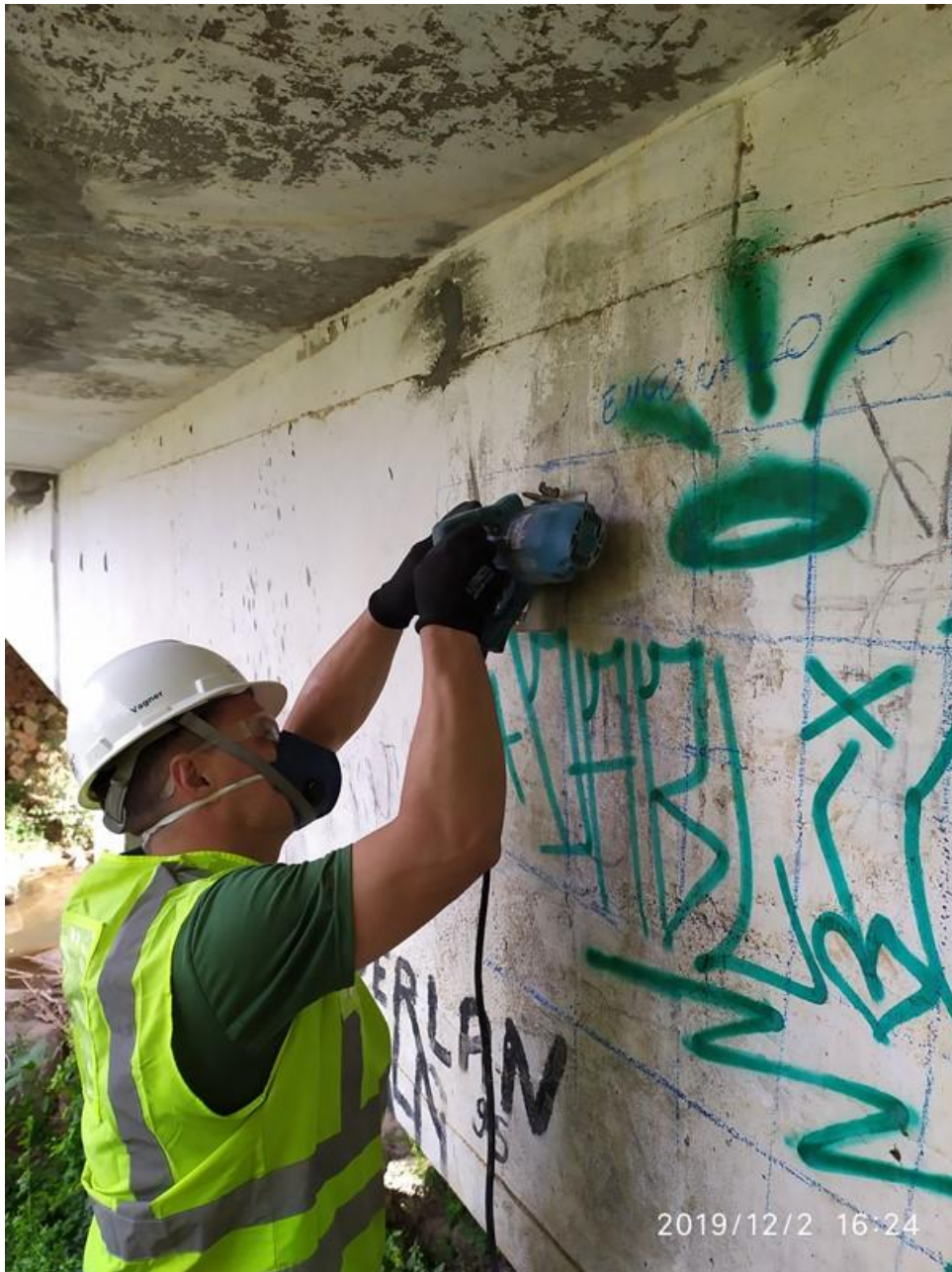
Foto 2: Corte para ensaio de carbonatação – Viga Longarina Leste – Balanço 2.
