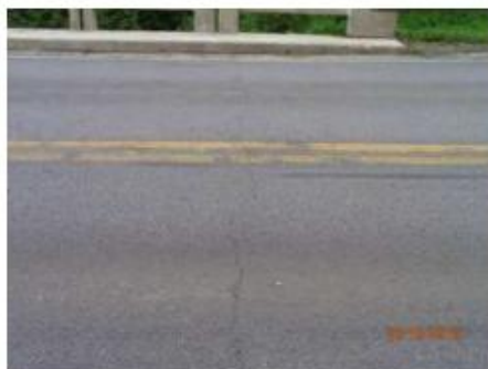
Foto 7. Junta recoberta com sinais de ruptura.
