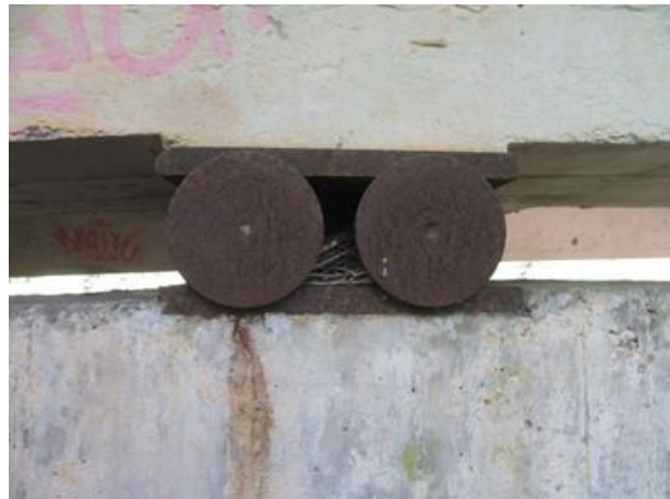
Foto 25: Rolete metálico - oxidação e acúmulo de detritos.
